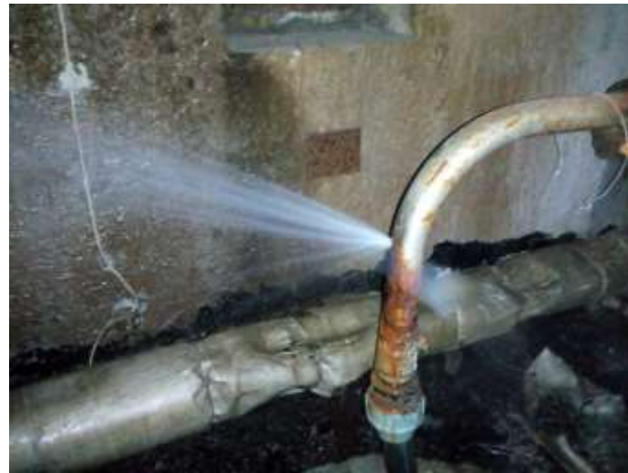
имеется течь из котла
