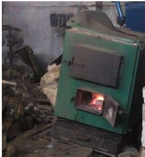
имеется механическое повреждение корпуса котла
