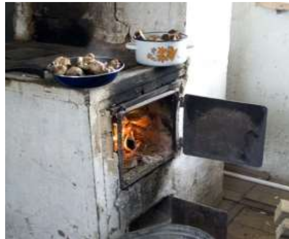
топочная дверца печи неисправна (не закрывается)
