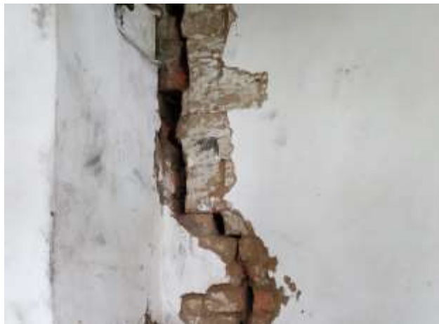
имеется сквозная трещина в печи
